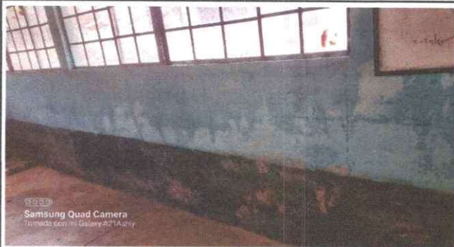
Foto 3: La pintura del muro de la pared en el interior y exterior de la escuela se necesita mejorar.
