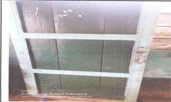
Foto 1: La puerta de la escuela se encuentra en mal estado es necesario sustituir por puerta metálica.
